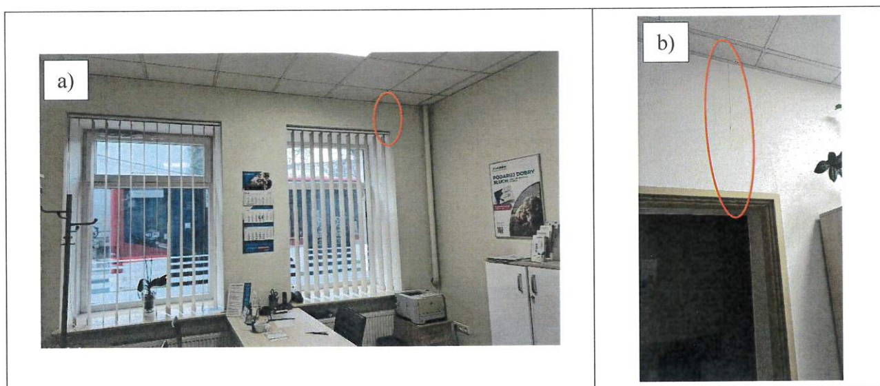
Fot. 7. Uszkodzenia występujące w lokalu użytkowym na parterze, które pojawiły się tuż przed katastrofą: a) rysa pionowa w nadprożu okna po prawej stronie, b) rysa pionowa nad otworem drzwiowym w ścianie wewnętrznej
